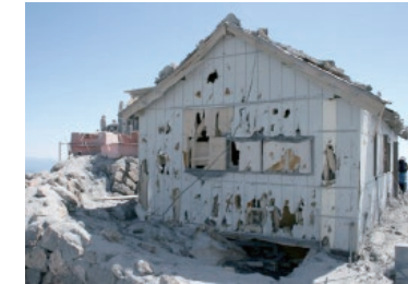
火口に向けた壁が噴石で被災した山小屋(御嶽山)
