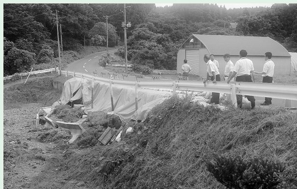
7月の豪雨で被害があった市道古安鹿・寺地線
