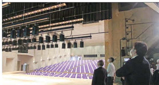
昇降が電動化された ホールの舞台吊物機構
