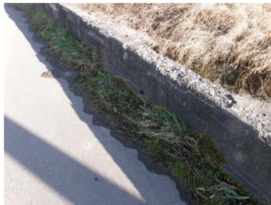
写真3-1 凍害による損傷（法量橋）
