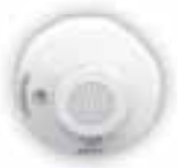
新たに設置された住宅用火災警報器
