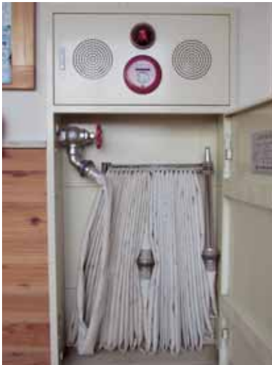
1 学校内の消防せつび
