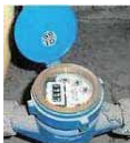
5 水道メーター
