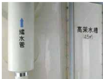
3 2階の上にある高架水そう
