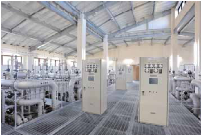
3 膜ろ過設備—水の中のごれをとるところ
