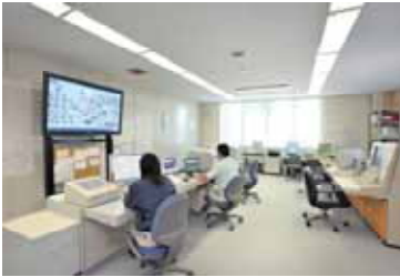
⑤中央管理室 コンピュータを使って、 24時間かんししています。
