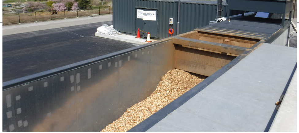
木質チップを燃料とする「森林（もり）の発電所」。発電規模は45kW。
