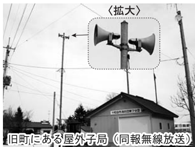
旧町にある屋外子局 (同報無線放送)
