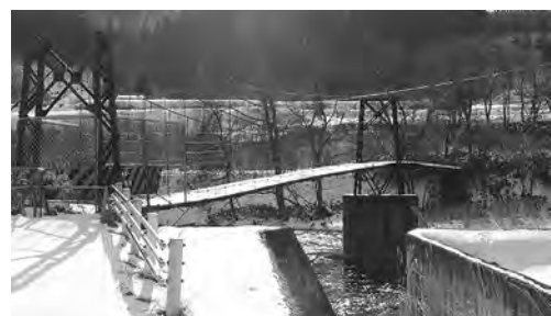
老朽化著しい银杏橋
