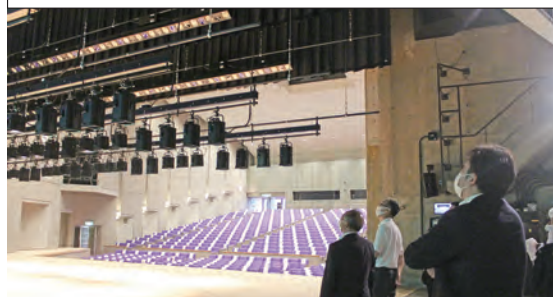
昇降が電動化された ホールの舞台吊物機構
