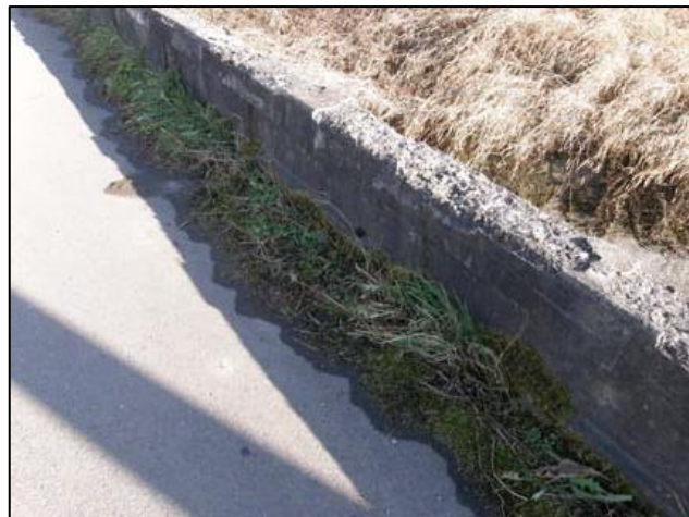
写真3-1 凍害による損傷
