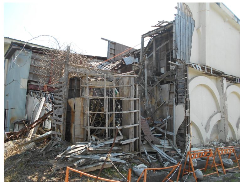
崩壊状態となっている増築部分
