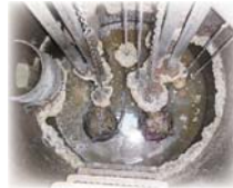
下水道管で冷えて固まった油分
