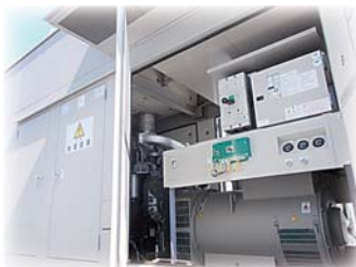
【自家発電設備】
